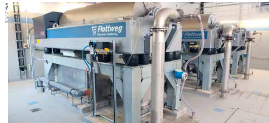
Flottweg-Zentrifugen im Einsatz in einer Kläranlage
