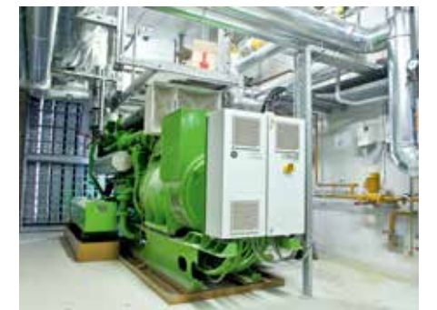
Energieeffizienz der REWAG: eine dezentrale Erzeugungsanlage, genannt BHKW. Foto: REWAG
