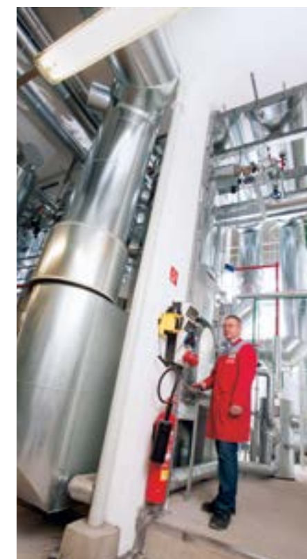
Wärmetauscher-Kaskaden des Blockheizkraftwerks mit dem leitenden Ingenieur Josef Scheuermeyer
