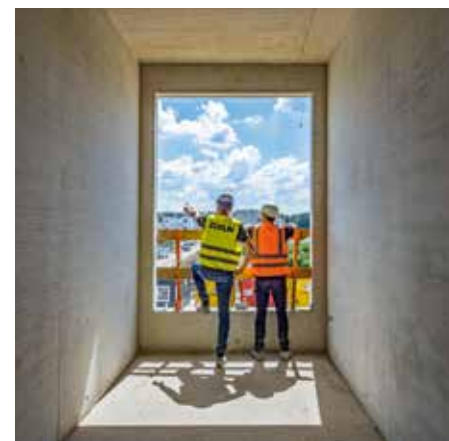
Fast 100 Prozent der Oberflächen im neuen Gebäudekomplex bestehen aus Sichtbeton. Außergewöhnlich daran: Der Sichtbeton bildet keine glatte Oberfläche. Er ist durch eine dezente Maserung – Holz nachempfunden – gekennzeichnet.
